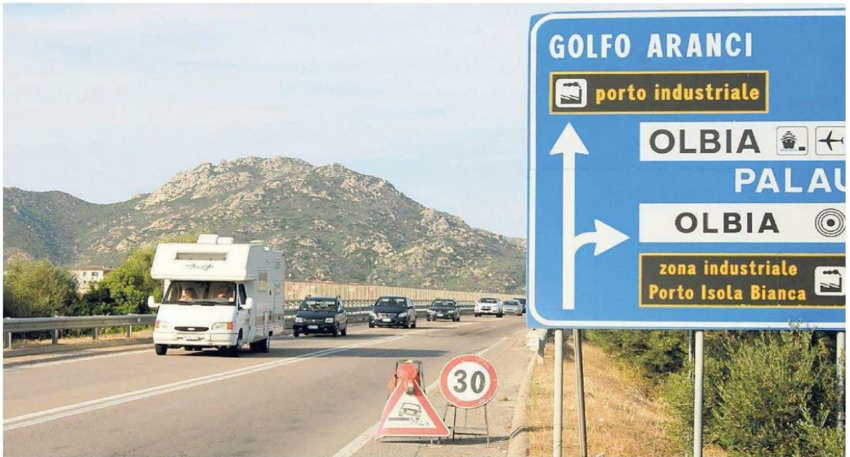
Un tratto della Circonvallazione ovest che verrà sottoposta ai lavori di manutenzione di cui il Cipnes è l'ente attuatore
